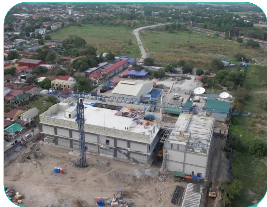
Angeles Data Center
